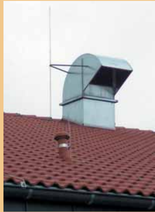
Isolierter Aufbau von Auffangeinrichtungen auf einem Pfannendach.
