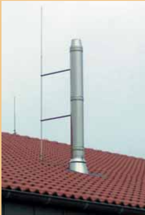
Isolierter Aufbau von Auffangeinrichtungen auf einem Pfannendach.
