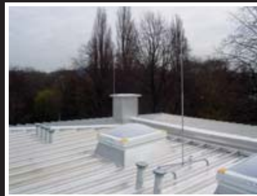
Foto: RAL - Gütegemeinschaft für Blitzschutzanlagen e.V.
